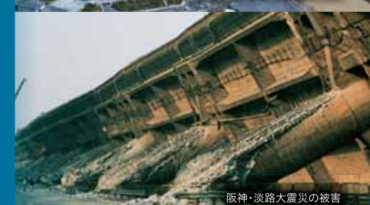
阪神・淡路大震災の被害
