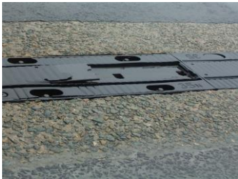
ジョイントの損傷 (ゴムのはがれ)
