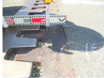
ジョイントの損傷 (浮き、段差発生)
