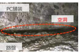
【PC舗装と路盤間の空洞】
