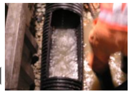
【排水管内の遊離石灰堆積状況】
