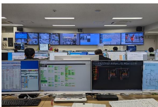
設備監視（大阪地区）
