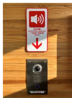
非常用インターフォンの設置
