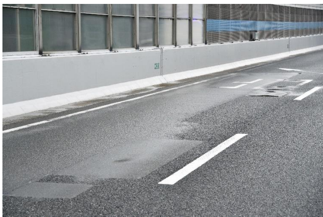
舗装補修（補修前）
