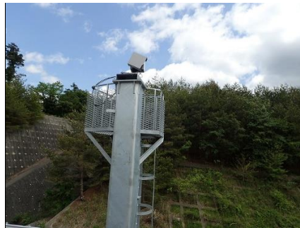
交通流監視カメラ設置例
