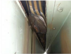
伸縮装置の損傷 (止水破損)
