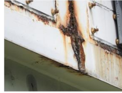
鋼製高欄部の損傷 (漏水による腐食)
