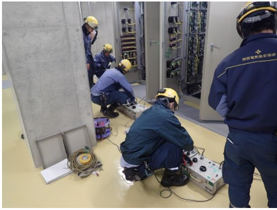
受配電設備点検
