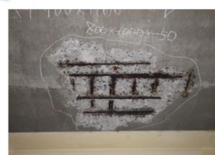
RC床版の損傷 (鉄筋露出)
