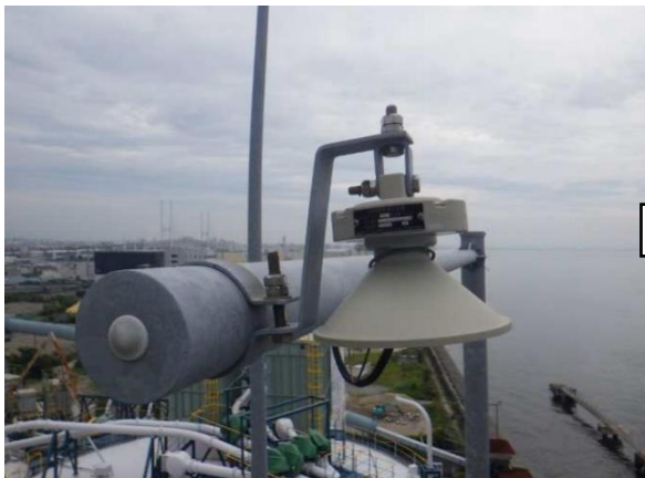
車両検知ヘッド補修前
