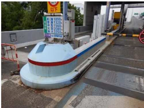
料金所アイランド損傷（補修前）
