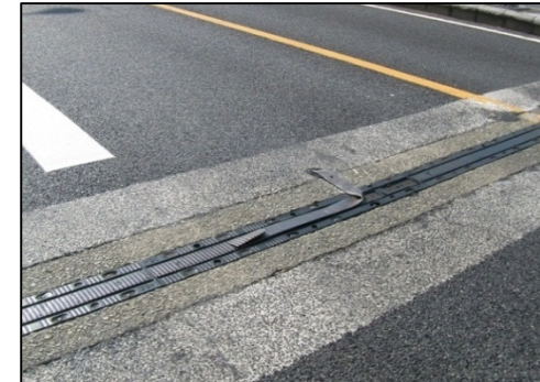
ゴムジョイントの損傷事例 (鋼板の露出)
