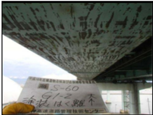
橋梁の全面的な塗膜劣化
