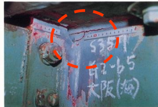
写真-4 タイプ4と1の損傷
