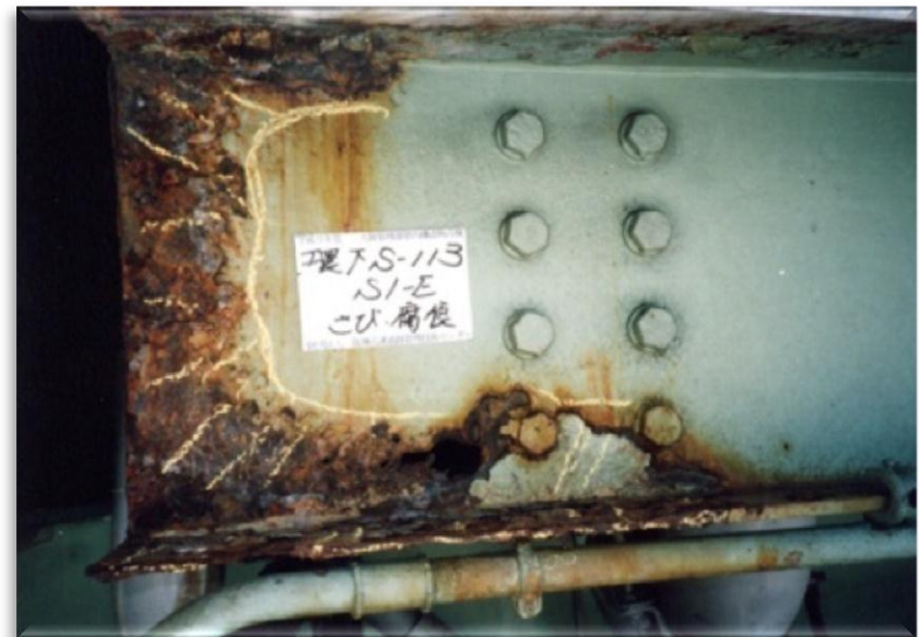
側縦桁の腐食事例
