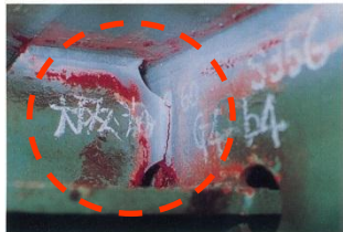
写真-3 タイプ3の損傷
