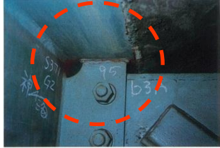
写真-1 タイプ1の損傷
