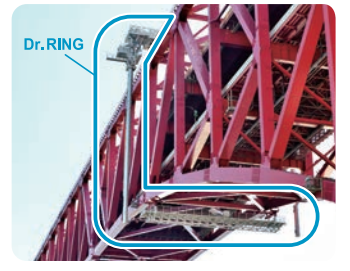
橋を囲うように「口の字型」となっているほか、上下降可能な作業車が設置されており、より広範囲の点検を可能にしています。
