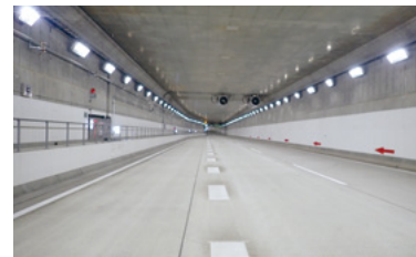
LED道路照明
