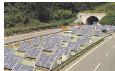
太陽光発電 (7号北神戸線長坂山トンネル坑口付近)
