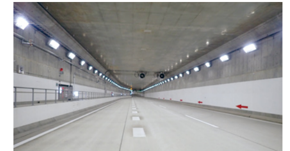
LED道路照明
