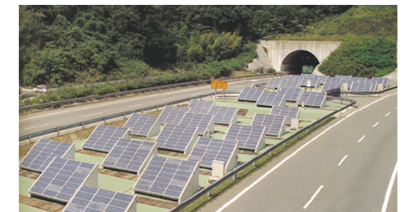
太陽光発電(7号北神戸線長坂山トンネル坑口付近)
