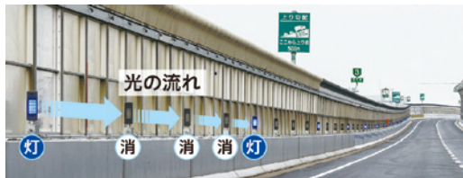
3号神戸線(東行)深江サグ部付近における速度回復誘導灯の設置
