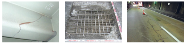
構造物の老朽化が発生
