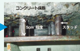
スタッドの露出状況
