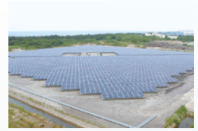
リースレンタル事業 (太陽光発電システム)
