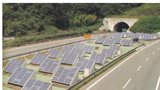
太陽光発電(7号北神戸線長坂山トンネル坑口付近)
