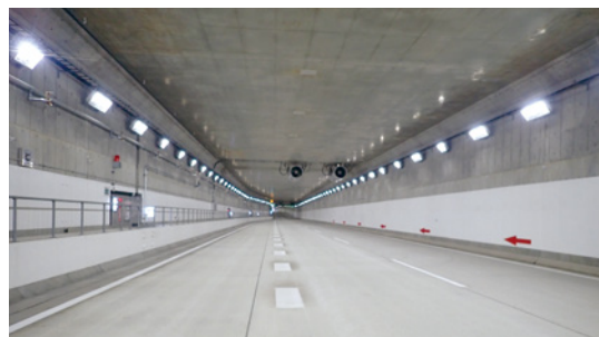
LED道路照明
