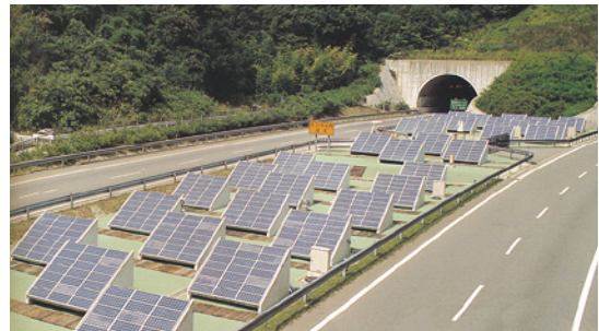
太陽光発電(7号北神戸線長坂山トンネル坑口付近)
