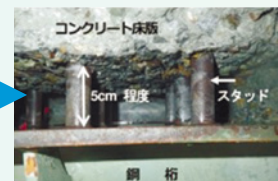
スタッドの露出状況
