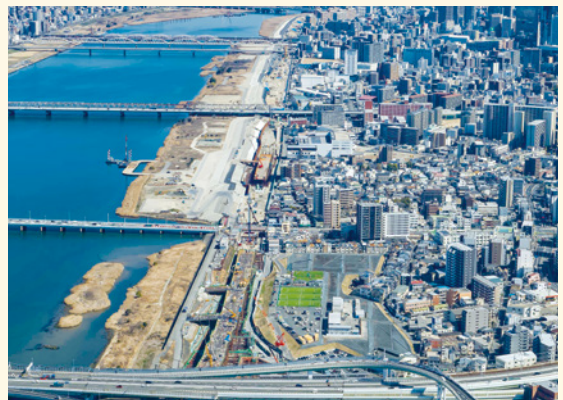
淀川の堤防沿いにトンネル構造で建設中の淀川左岸線(2期)
