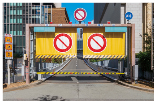
入口遠隔閉鎖装置（中之島入口）
