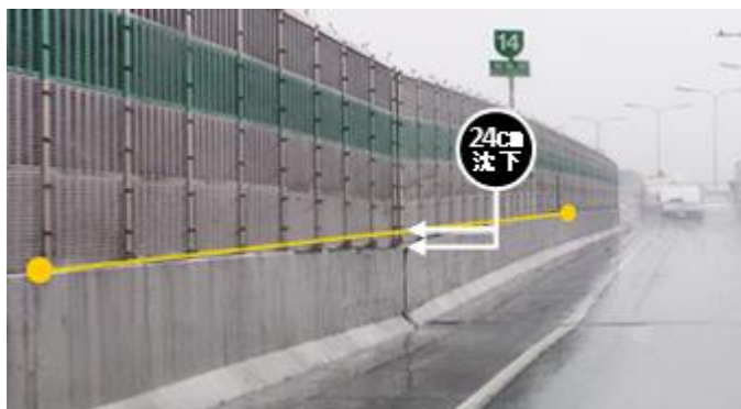
橋桁中央部の沈下状況
