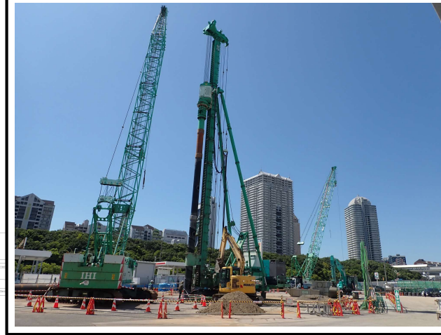
【2】橋脚(PPE-3)基礎工事において、鋼管矢板継手部の先行削孔中。
