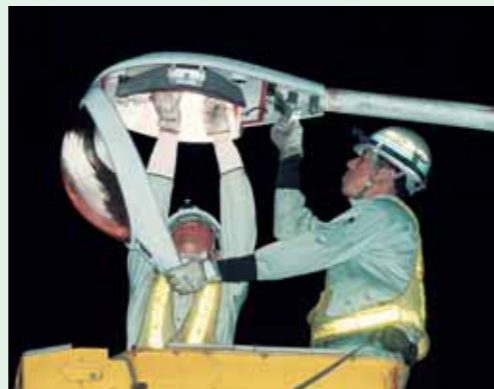
車線規制を行い、高所作業車を使い、照明の球を交換します。工事は交通量の少ない夜間しかできないため、つねに危険が伴います。
