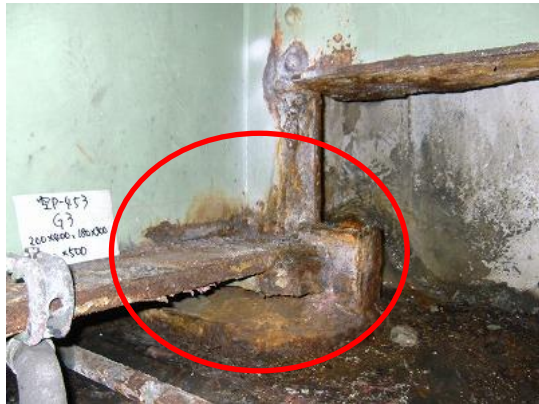
鋼桁端部の腐食による断面減少
