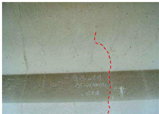
主桁のひびわれ
