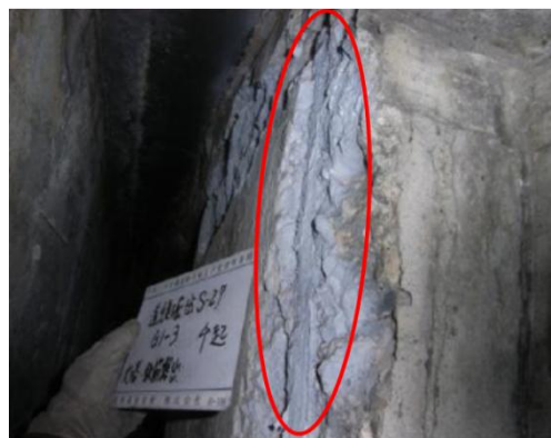
主桁の鉄筋露出
