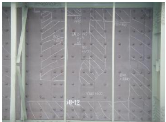
鋼板補強されたRC床版で不良音を確認された部位のチョーキング
