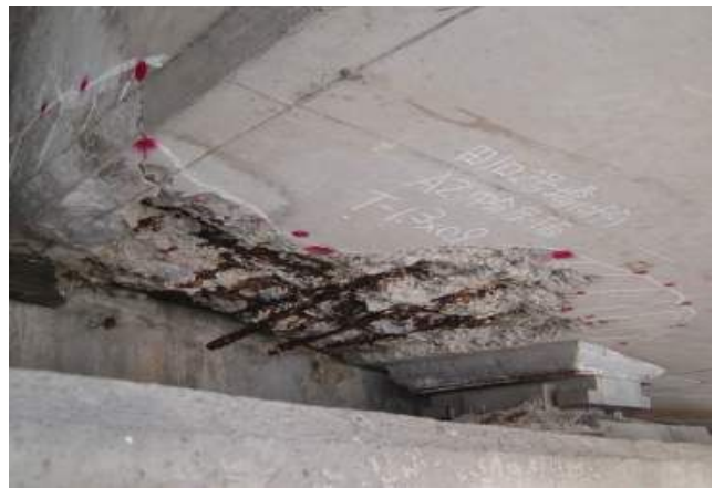
写真 2 桁端部に代表される狭隘部の損傷例
