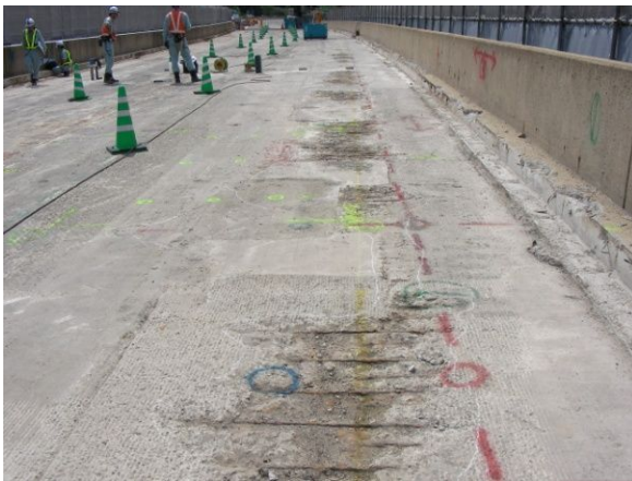
写真 1 舗装下のコンクリート床版の損傷例
